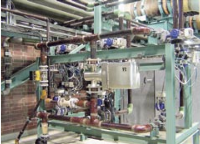
6 OPUS-Sonde, installiert als zentrale Messstation für 3 Wäscherlinien 6 OPUS probe installed as central measuring stage for 3 scrubber lines
